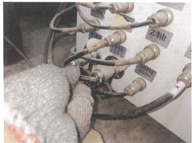
電線未妥善處理，恐有導致破損之虞。
