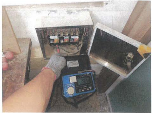
絕緣電阻值量測。
