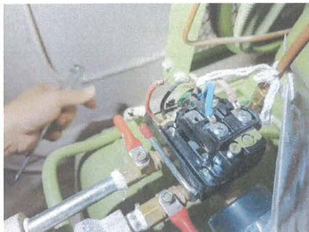
電線未使用端子。
