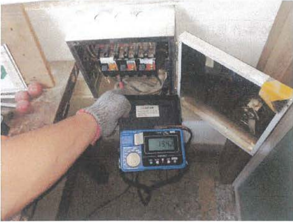
絕緣電阻值量測。
