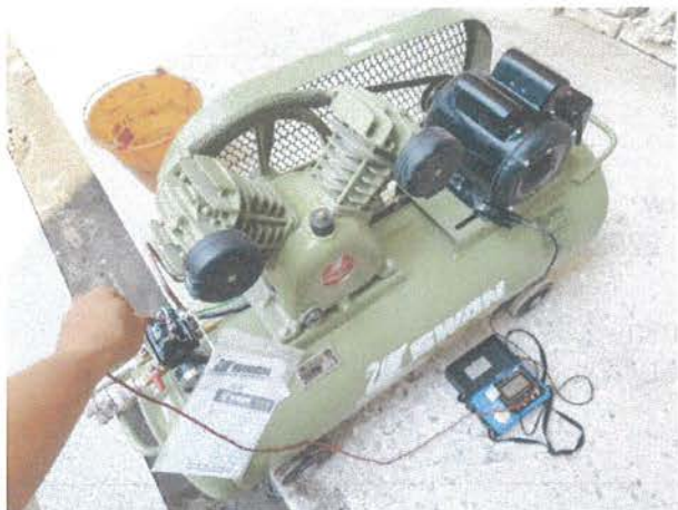
絕緣電阻值量測。
