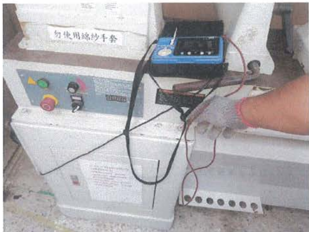
絕緣電阻值量測。
