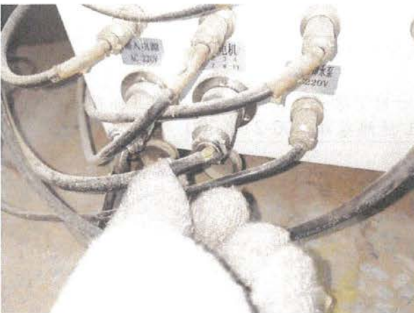
電線未妥善處理，恐有導致破損之虞。
