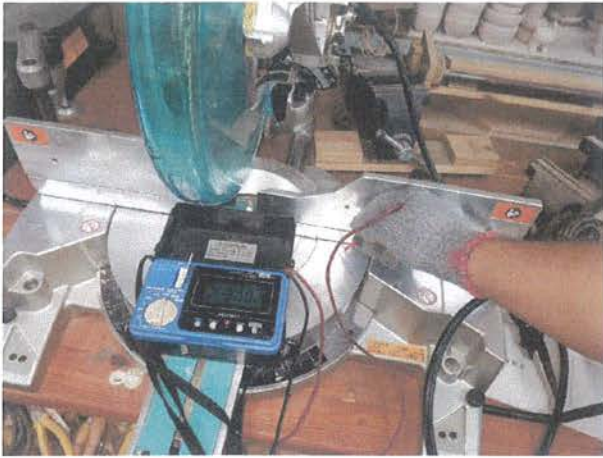
絕緣電阻值量測。
