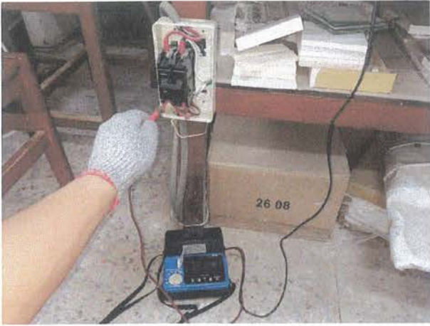
絕緣電阻值量測。
