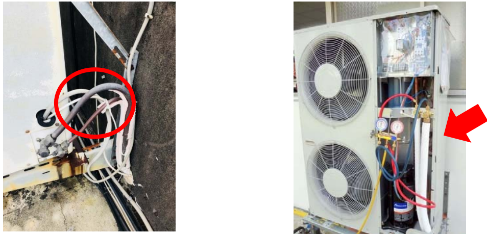
圖 6、冰水管路應妥善包裹適當材料之保溫棉以維持冷房效果
