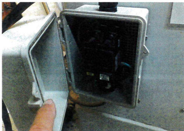
實際相片(電源盒損壞)
