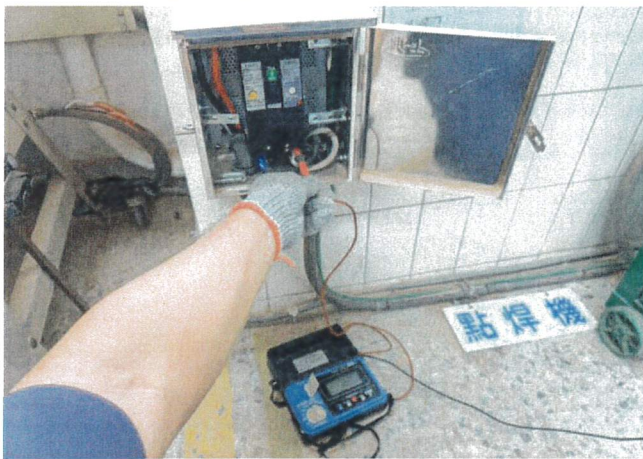
絕緣電阻值量測
