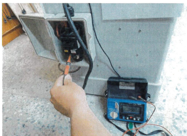
絕緣電阻值量測。
