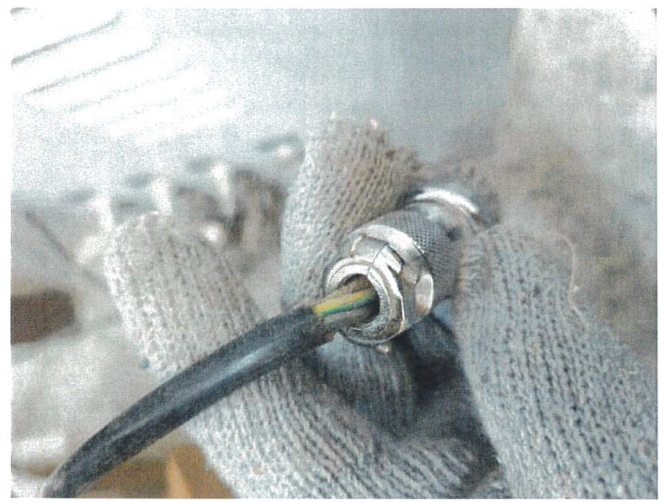
電線包覆不良，有破損之虞
