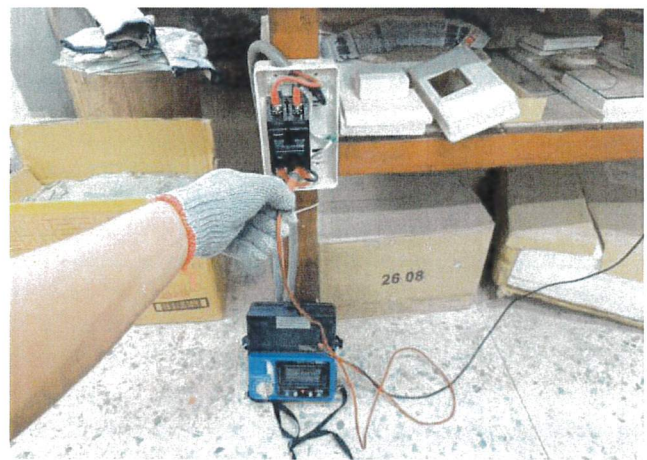
絕緣電阻值量測
