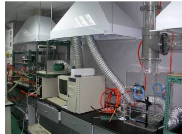
局部排氣裝置
